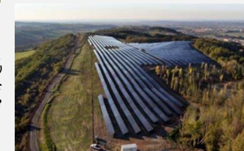
Centrale Solaire du SEQUESTRE Département du Tarn (81) Puissance électrique : 4 500 kWc Mise en service : Octobre 2013
